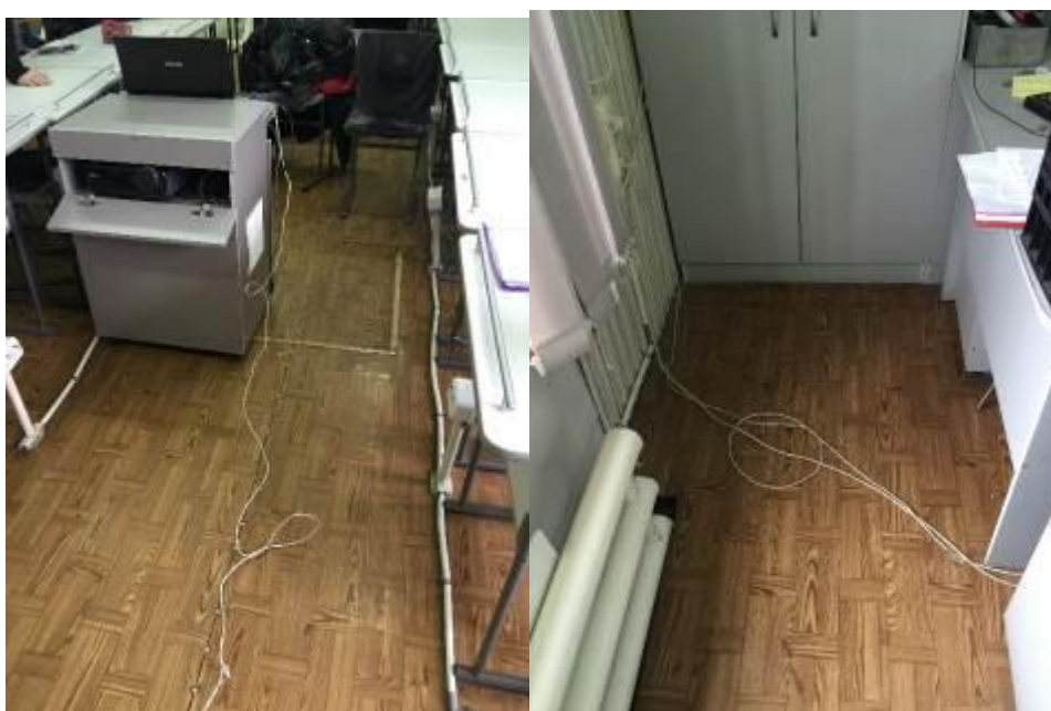
Рисунок 3 – Подключение кабеля сети Интернет к рабочему месту учителя и тумбе с проекционным оборудованием
