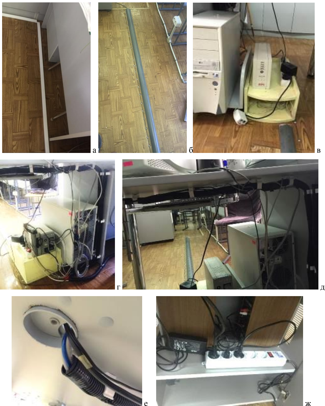
Рисунок 17 - Фотографии реализованного проекта оборудования кабинета предмета «Технология» для безопасного использования компьютерной техники: а–в - монтажные узлы крепления кабель-канала к полу с установленными в нем сетевыми кабелями; г-е - монтажные узлы крепления гофрированной трубы с размещенных в ней кабелей к столешнице и стенке компьютерного стола; ж – монтажный узел установки сетевого фильтра к передвижной тумбе
