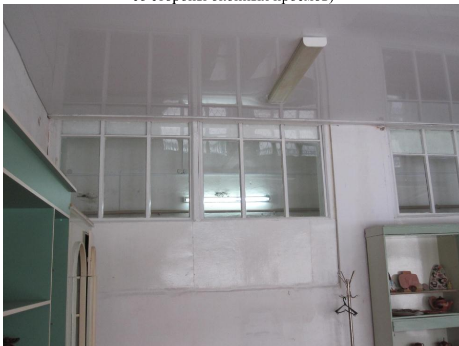
Рисунок 7 – Фотография реализованного проекта монтажа натяжного потолка (вид с противоположной стороны от оконных проемов)
