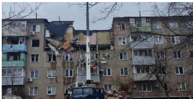
Рисунок 1 – Общий вид повреждений жилого пятиэтажного панельного здания в результате взрыва бытового газа
