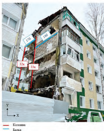
Рисунок 3 – Геодезические измерения разрушенной части здания
